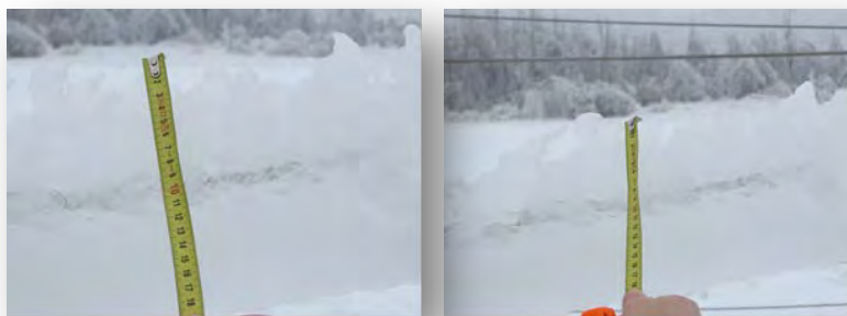
Slika 6.9.-9. – Naslaga leda na vodiču. Izmjereno na OPGW-u : OPGW ASLH-D(S)bb 2x24 SMF (AA/ACS 92/43 –11,3) dalekovoda 110 kV DV 131 VINODOL - VRATA 2 u priključnom rasponu između krajnjeg stupa broj 1 i EVP 110/25 kV
